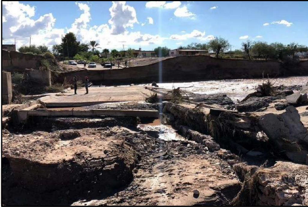
Figura 12.- Se muestran los daños causados por el Huracán “Rosa” en un vado del Río Sonoyta, el cual quedo destruido totalmente
