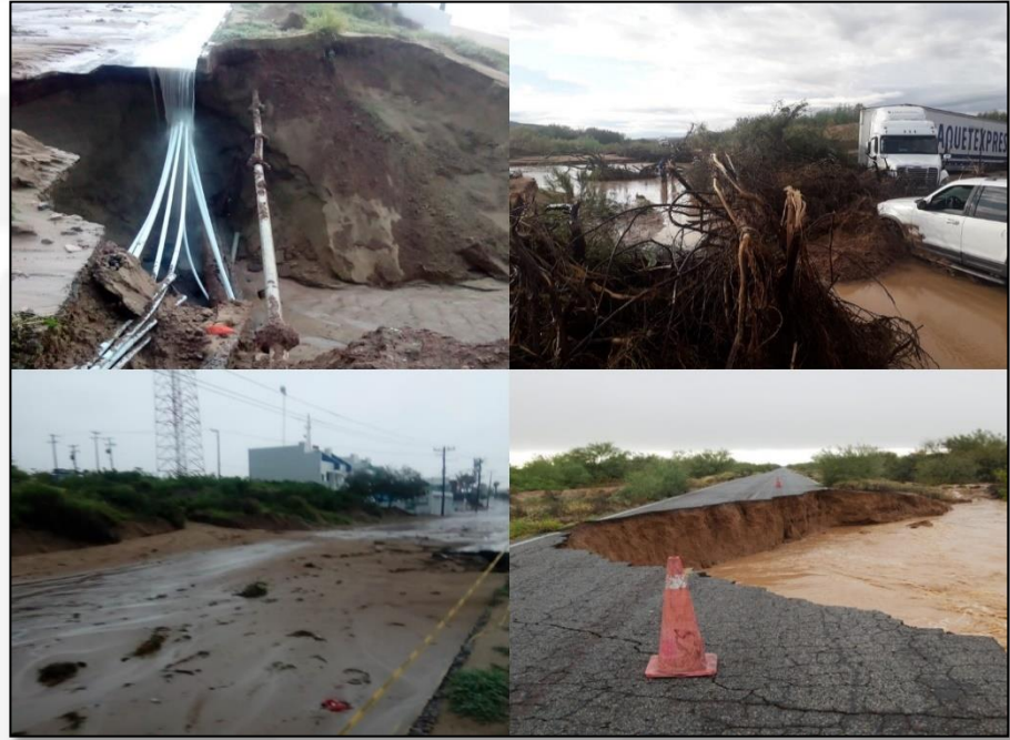
Figura 13.- Daños provocados por el paso del Ciclón Tropical “Lorena” en la infraestructura de carreteras y vialidades urbanas de la zona
